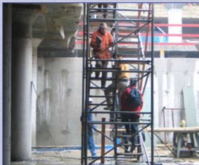
► Le bassin d'orage Flagey
