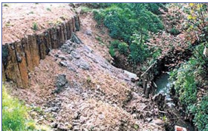
▶ Instorting van de rechteroever in de zone Ets Deveugle, tegengehouden door paal- en plankwerk.
