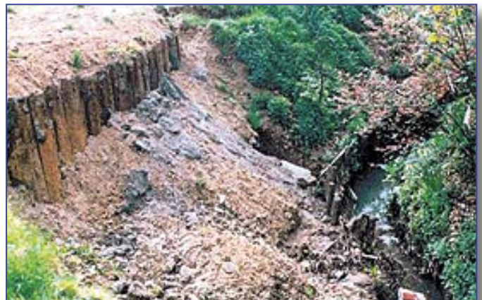
► Effondrement de berge en rive droite dans la Zone Ets Deveugle, contenu par des palplanches
