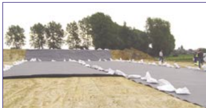
► Slibstort Rebaix – 'ingravingszone' - September 2006: plaatsing van een 2e strook van het waterdicht membraan voordat de twee stroken aan elkaar worden 'gelast'.
