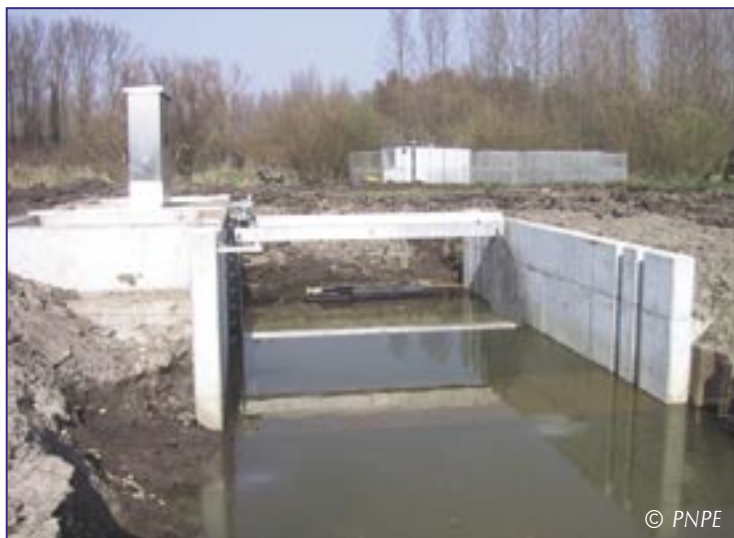
► Seuil mobile équipé d'une passe à poisson sur la Verne de Bury
